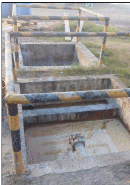
Piletas – Sistema Interceptador – Decantador
