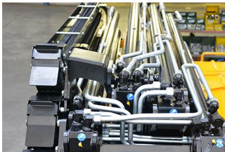
Fig. 2-2. Tuberías de alta presión
