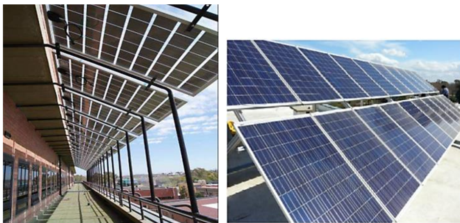
Figura 15. Sistemas FV instalados en el edificio TANDAR (CAC): (a) pérgola FV con 23 módulos de 215 Wp, ubicada en el tercer piso del edificio (izquierda); (b) 20 módulos FV de 240 Wp, ubicados en la terraza (derecha). Fuente: artículo del CONICET.
