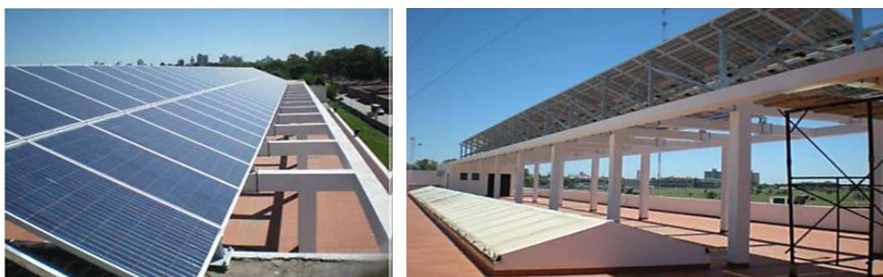
Figura 16 .Pérgola FV de 17 kWp en la Facultad de Informática de la UNLP. (Publicaciones del CONICET 10 ).
