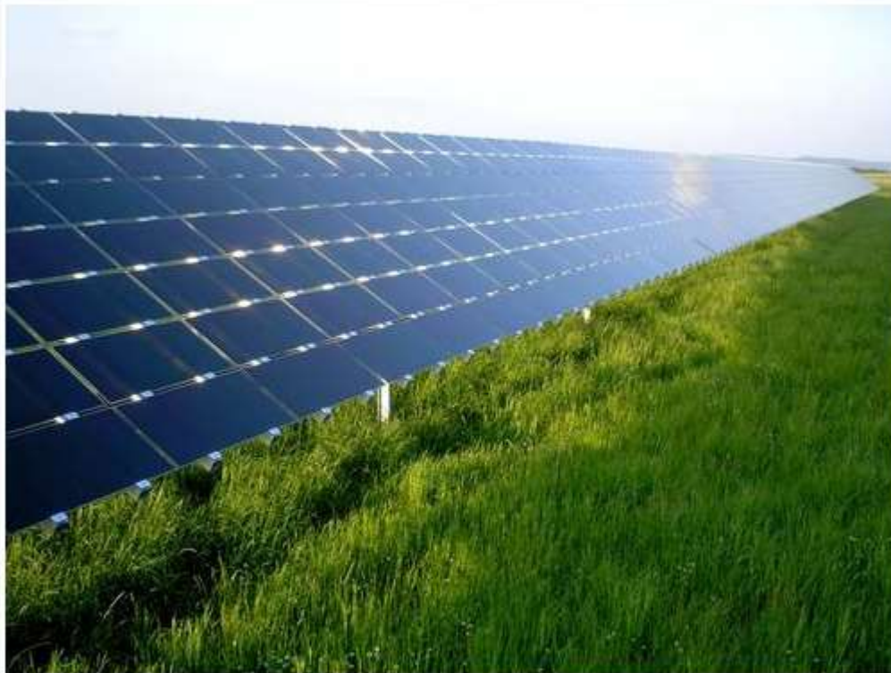
Panel solar fotovoltaico de capa fina
