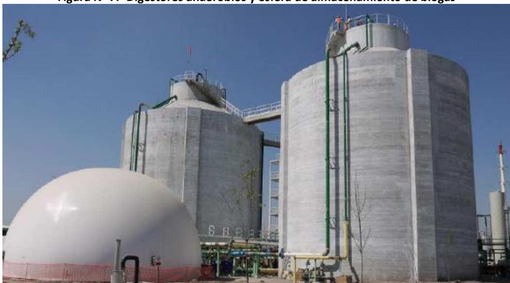
Figura N° 7.- Digestores anaerobios y esfera de almacenamiento de biogás
