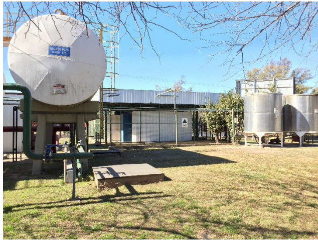
Imagen 3: Ubicación de cuadro de válvulas y tanques de almacenamiento de agua de Rinser
