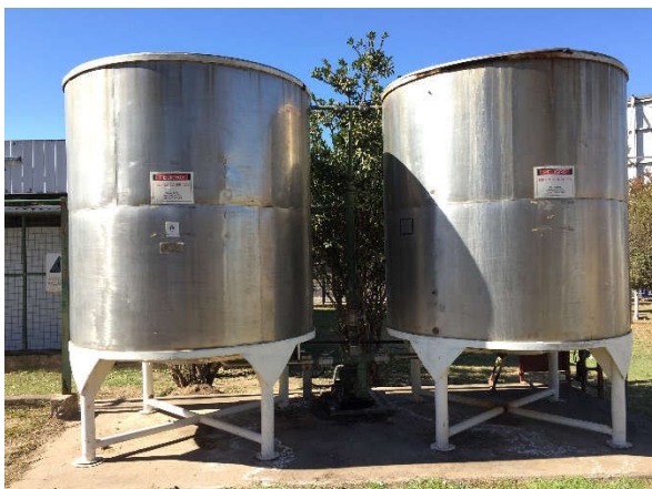
Imagen 5: Tanques de almacenamiento de agua recuperada Rinser
