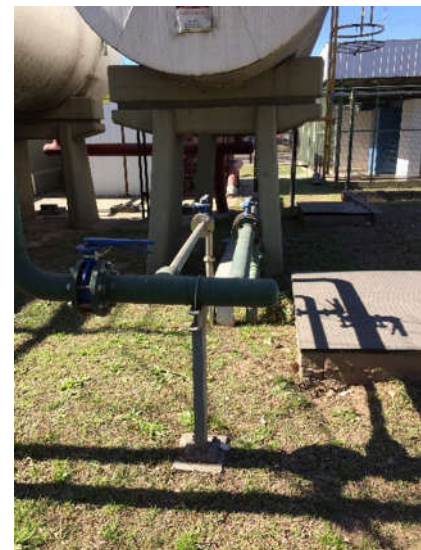
Imagen 4: Cuadro de válvulas pozos 3 y 4
