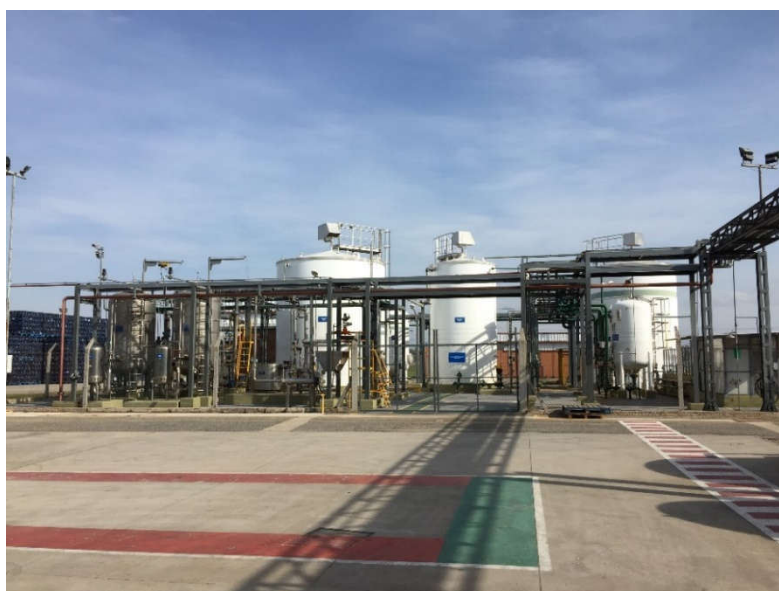
Imagen 1: Planta de Tratamiento de Agua
