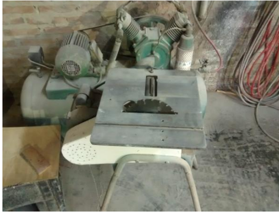
Máquinas - herramientas sin protecciones y paradas de emergencia, posibilidad de atrapamiento, amputaciones y choque eléctrico.
