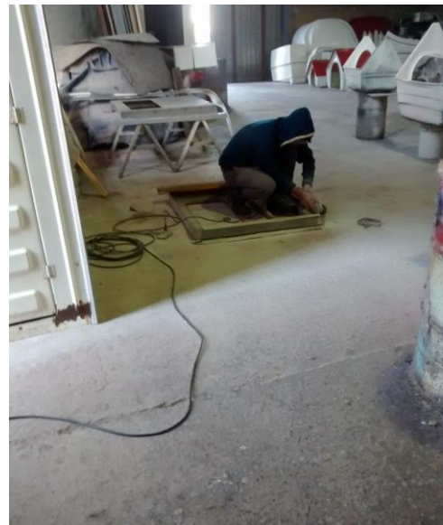
Utilización de máquina sin protecciones y EPP, posibilidad de proyección de objetos, inhalación de particulado, cortes y riesgo eléctrico
