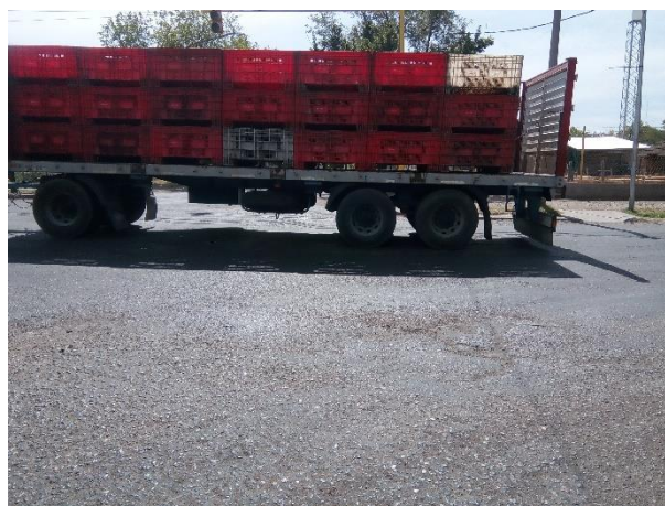
10- Circulación de carga pesada y deterioro de calzada. Intersección con V. Sarfield.
