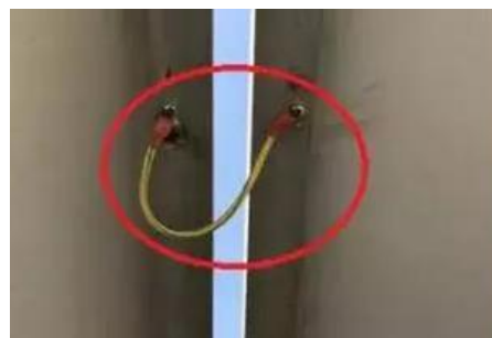
Ilustración 63 – Conexión de conductor de protección entre paneles solares
