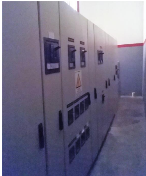
Ilustración 39 – Gabinetes principales y ubicación de inversores
