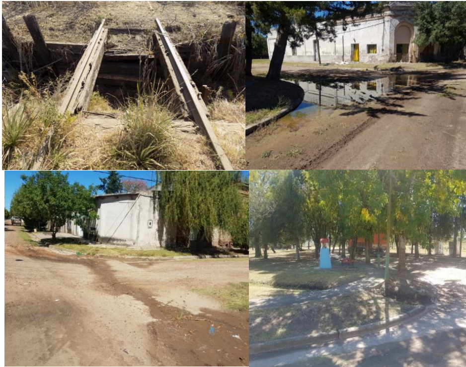
Figura 3-23, Imágenes del estado actual sistema de desagüe Fuente: Autoría propia
