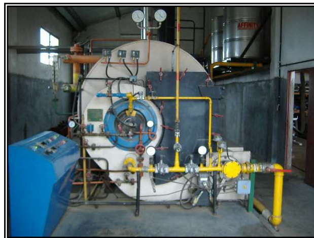
Imagen 21: Generador de vapor.
