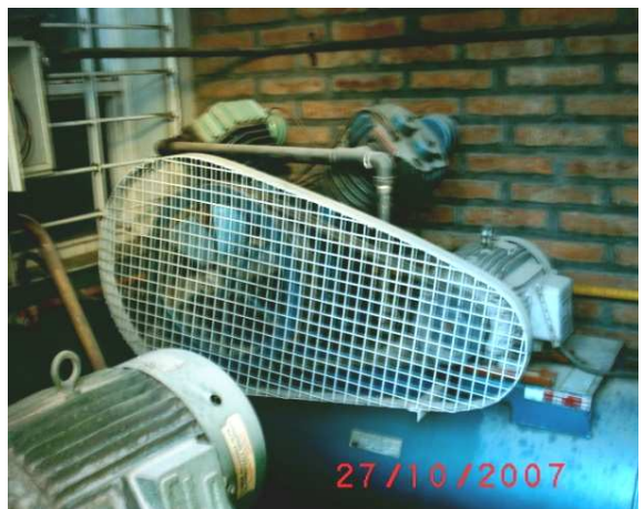
Sala de Máq. y de Compresores
