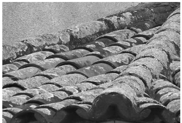
Figura 6: Detalle de la cubierta de la Iglesia: se observa una intensa contaminación biológica.
