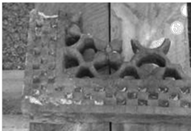
Figura 27: Rejilla de roca calcárea luego del crioarenado a 3.5 bar. La limpieza no resulta satisfactoria.
