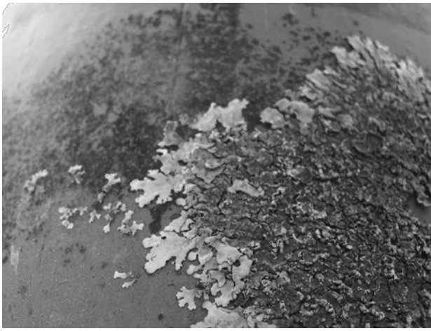
Figura 10: Se observa un trozo de teja colonizada.
