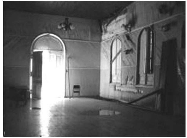
Figura 50: Interior del teatro inundado por la lluvia.
