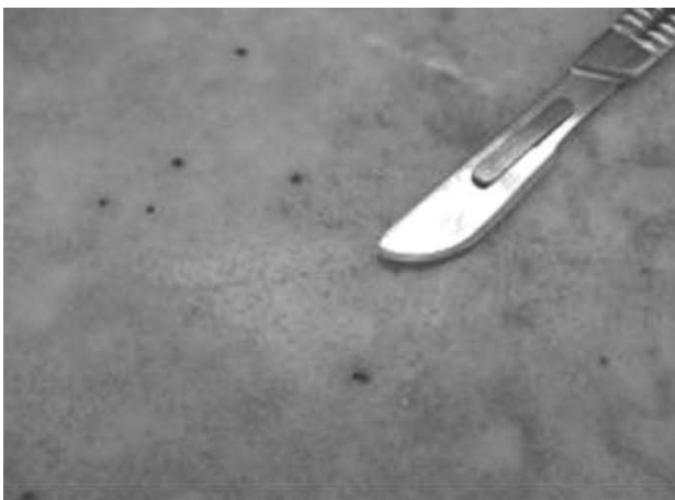
Figura 44: Superficie rugosa del mármol con oquedades.
