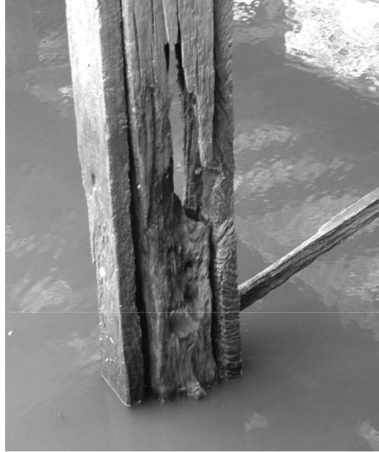
Figura 6: Estado de las columnas de madera.
