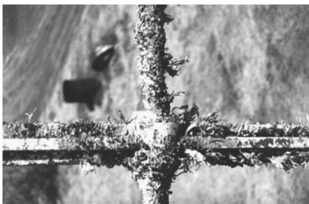
Figura 21: Líquenes sobre la baranda metálica del puente La Postrera sobre el río Salado.
