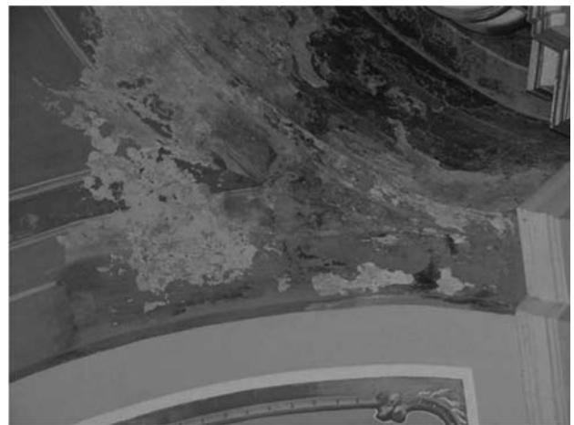
Figura 7: Iglesia de Magdalena. Paredes afectadas por colonias de bacterias y mohos.
