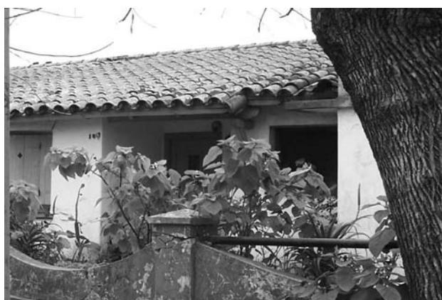
Figura 8: Detalle de la cubierta de una vivienda familiar. Se observa un manto biogénico en casi toda la totalidad del techo.
