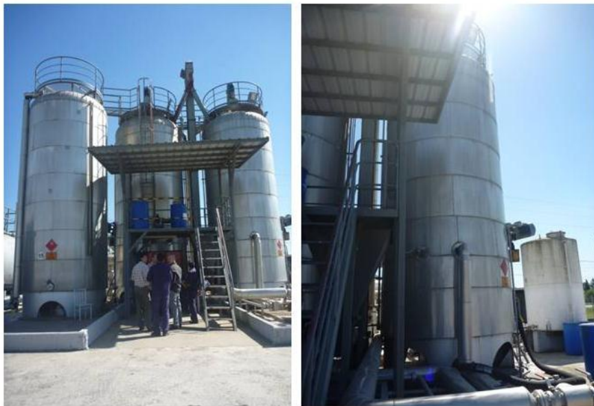
Figura 1. Vista de los tres tanques verticales de la planta y detalle de sistema de calentamiento de unos de ellos
