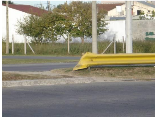
Figura 8: Terminal inadecuado e impactado sin reposición
