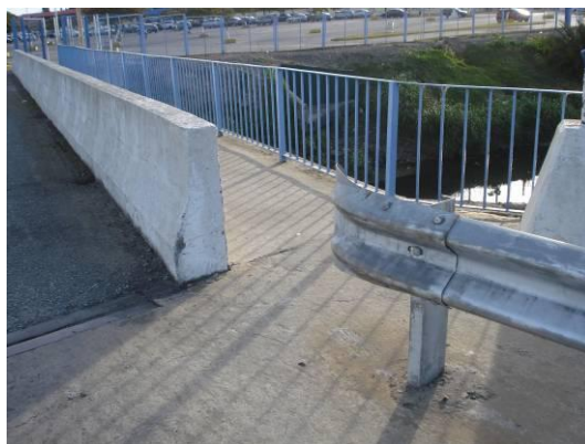
Figura 11: Peligrosa discontinuidad entre barreras rígidas y barreras flexibles
