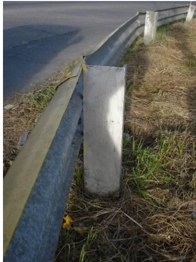
Figura 6: Ausencia de Bloque Separador
