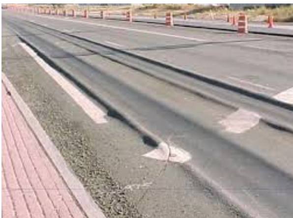
Figura 1. Ahuellamiento en pavimentos asfálticos.
