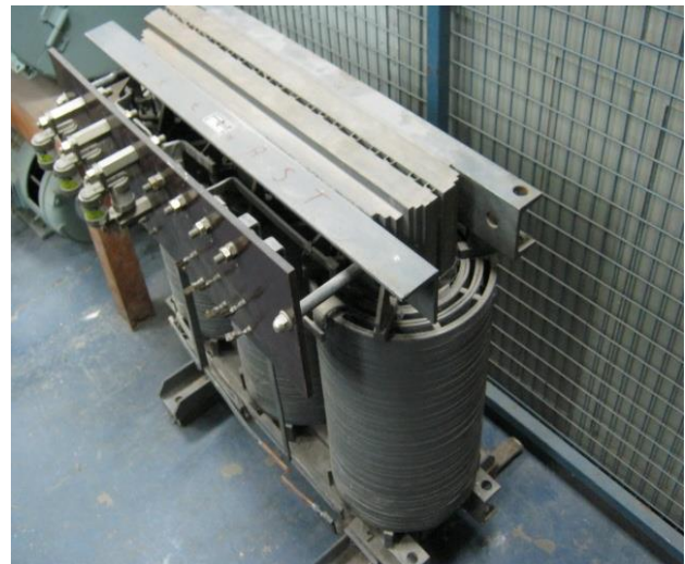
Fig. 5: Transformador objeto de estudio.
