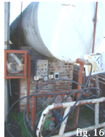
Fig.16 – Bombas Contra Incendio – Viano Const. SRL
