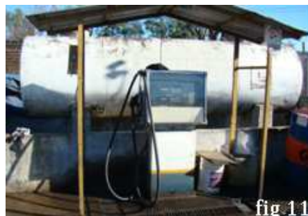
Fig.11 – Depósito Combustibles – Sector 4 – Empresa Viano Construcciones S.R.L.
