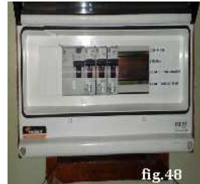
Fig.48 – Condiciones de las instalaciones eléctricas del sector de Pañol– Tablero seccional con DD y Int.TM.
