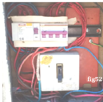
Fig.52 – Tablero Principal con DD, Termo magnética y salida p/ Bomba de Incendio (toma aguas arriba)
