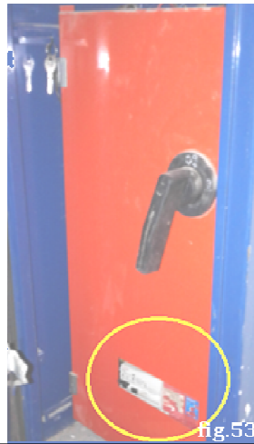
Fig.53 – Tablero Seccional con Doble puerta. Con DD e IT – Sector de Oficinas de Compras.
