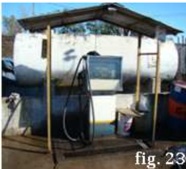
Fig.23 – Sector de Deposito de Combustibles, con sus Protecciones Pasivas presentes contra incendio.
