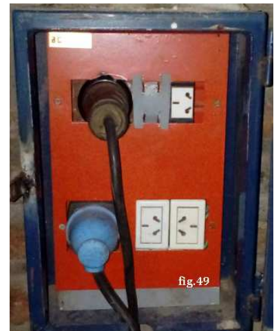
Fig.49 – Condiciones de las instalaciones eléctricas del sector de Depósito Cerrado – tablero de tomas
