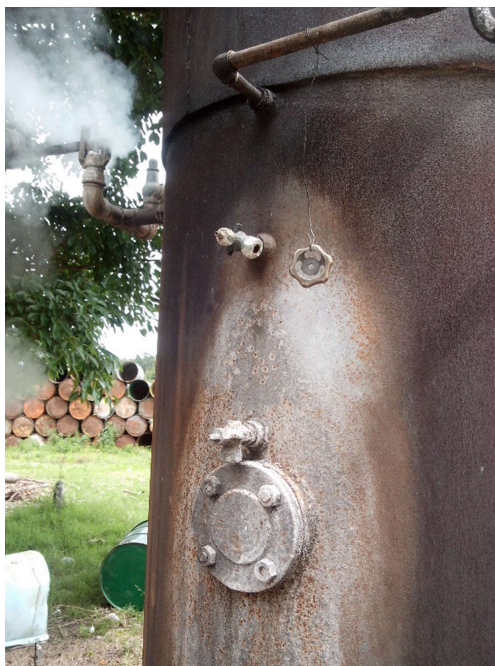
Imagen N°37: Foto de los accesorios donde debería estar el tubo de nivel de la caldera de vapor de la Citrícola Santa Carmen
