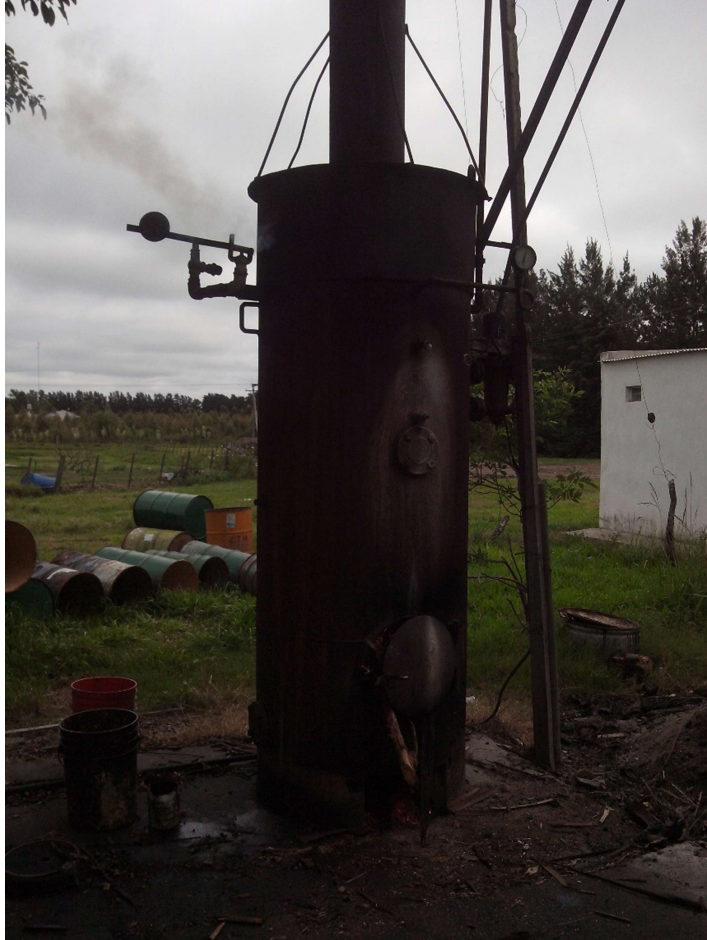
Imagen N°36: Foto de la caldera de vapor de la Citrícola Santa Carmen
