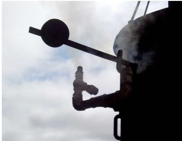
Imagen N°40: Foto de la válvula de seguridad tipo contrapeso de la caldera de vapor de la Citrícola Santa Carmen.
