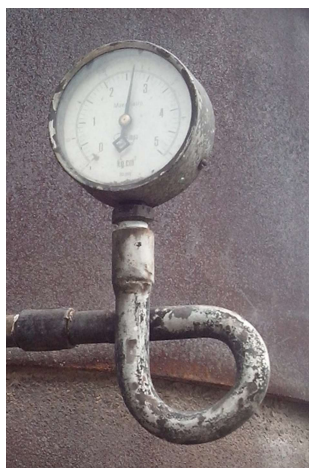
Imagen N°38: Foto del manómetro de la caldera de vapor de la Citrícola Santa Carmen
