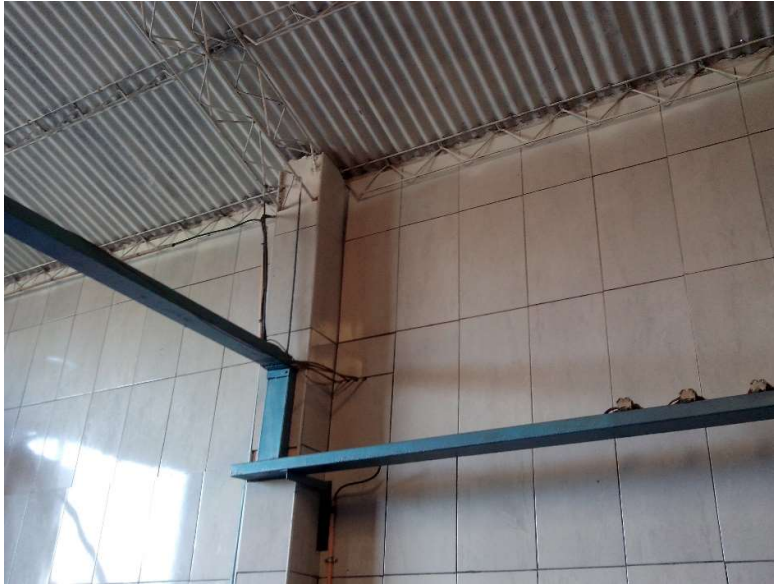
Imagen N°45: Foto de los conductores eléctricos instalados sobre bandejas de la Citrícola Santa Carmen.
