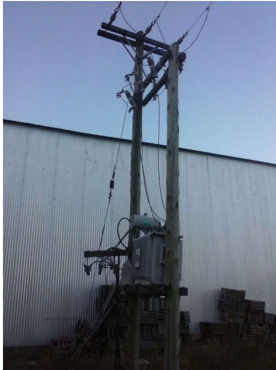
Imagen N°42: Foto de la baja de electricidad y transformador trifásico de la Citrícola Santa Carmen.
