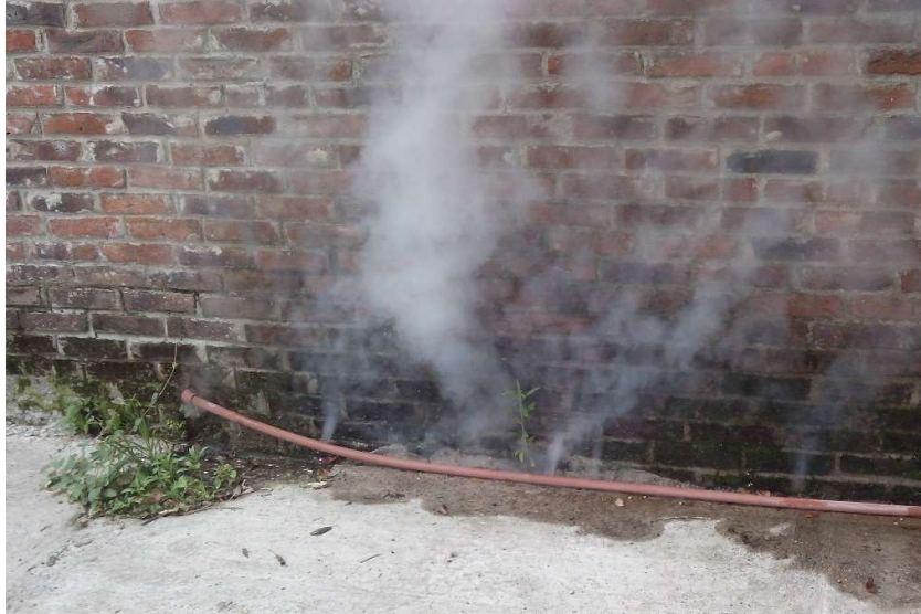
Imagen N°41: Foto de los caños de retorno de condensado de la caldera de vapor de la Citrícola Santa Carmen.
