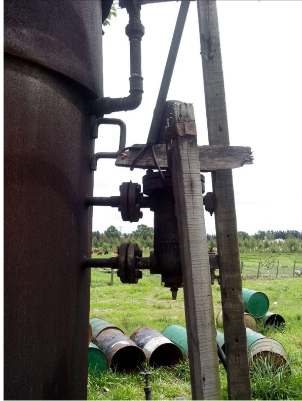
Imagen N°39: Foto del sensor magnético de nivel en desuso de la caldera de vapor de la Citrícola Santa Carmen
