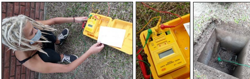
Figura 35: a y b)- Telurímetro SEW M98111991-01; c)- cables de PAT
