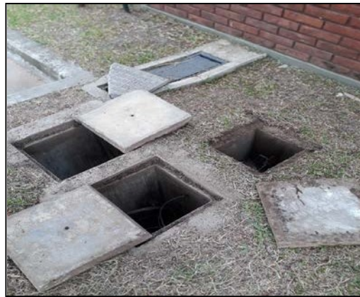
Figura 33: cámaras de inspección
