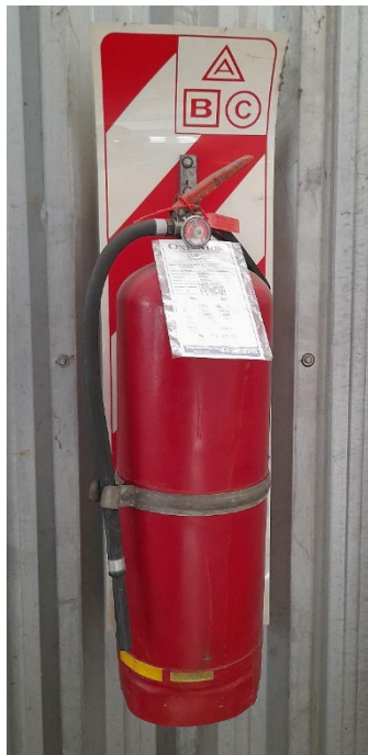
Imagen 10: Instalaciones contra incendios.
