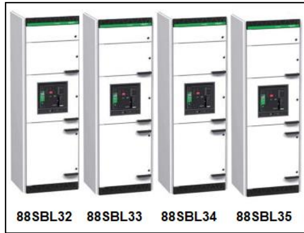
Figura IB-11: Schneider Eléctric, 2020, Orden de tableros de BT Batería 2, imagen, https://www.se.com/ar/es/ .
