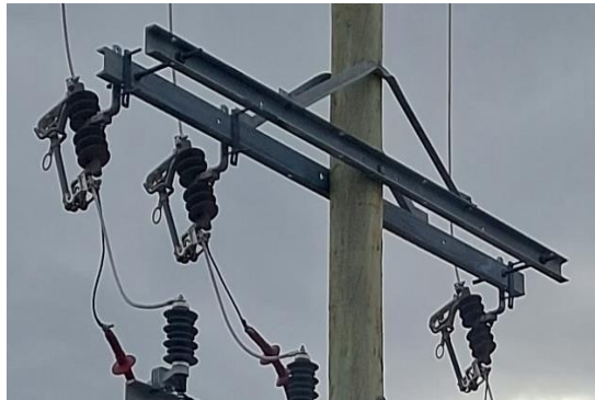
Figura 15: Seccionadores Fisibles XS Montados sobre Cabezal de Subestación
