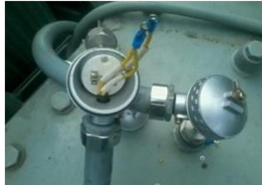
Figura 10: Contactos Sonda temperatura en Trafo
