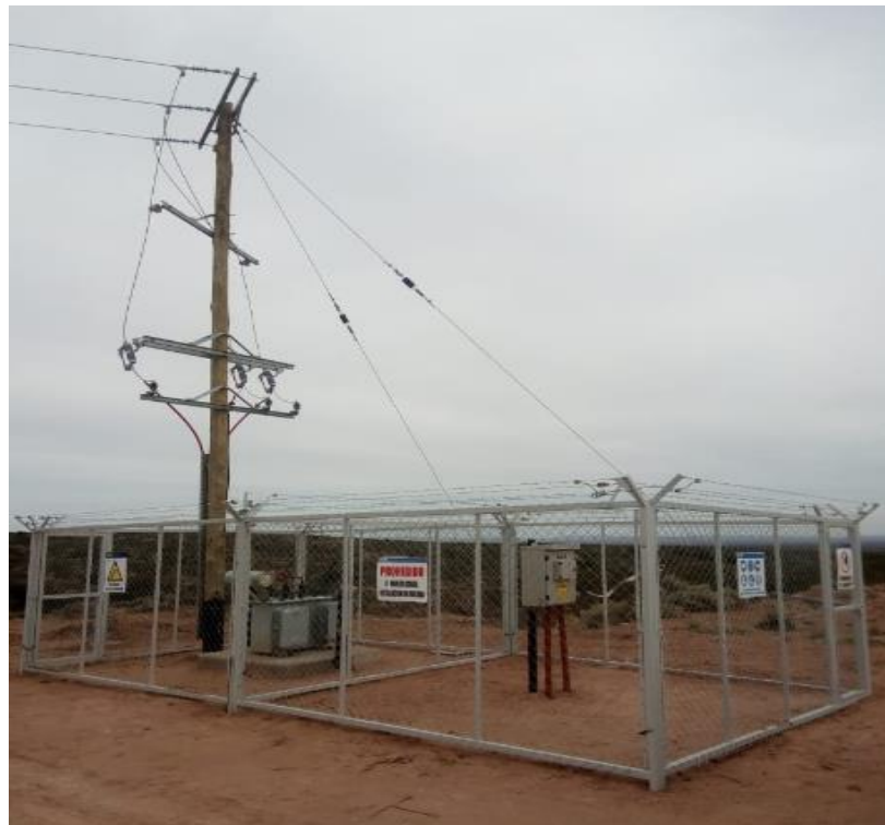
Figura 17: Vista de una SET de campo de Pozo único
