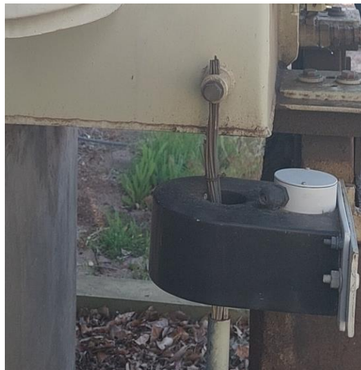
Figura 52: Transformador de Intensidad para sensado de Corriente de Fuga a Tierra
