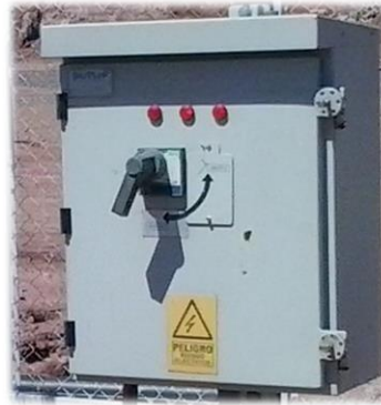
Figura 5: Tablero Seccionador BT
