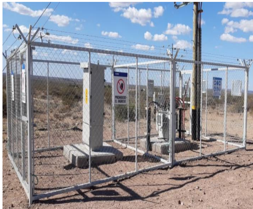
Figura:2: Vista de una SET de campo de 3 Pozos
