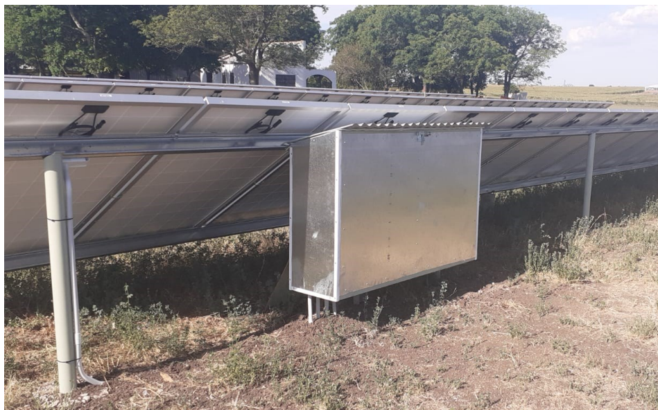
Figura 5.11. Estructura de soporte de los paneles y gabinete del inversor.
