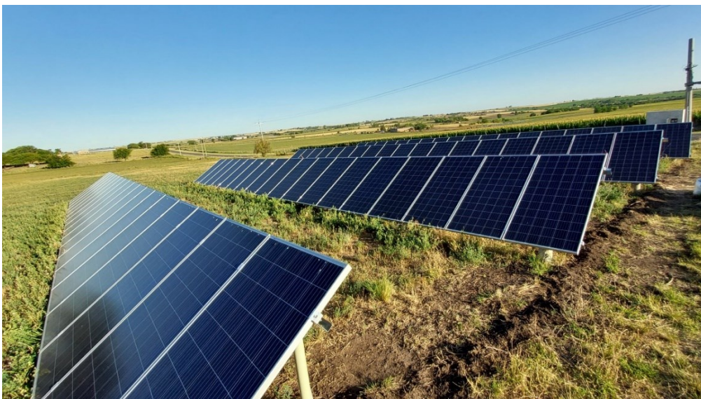
Figura 5.8. Disposición de los cuatro strings de paneles.
