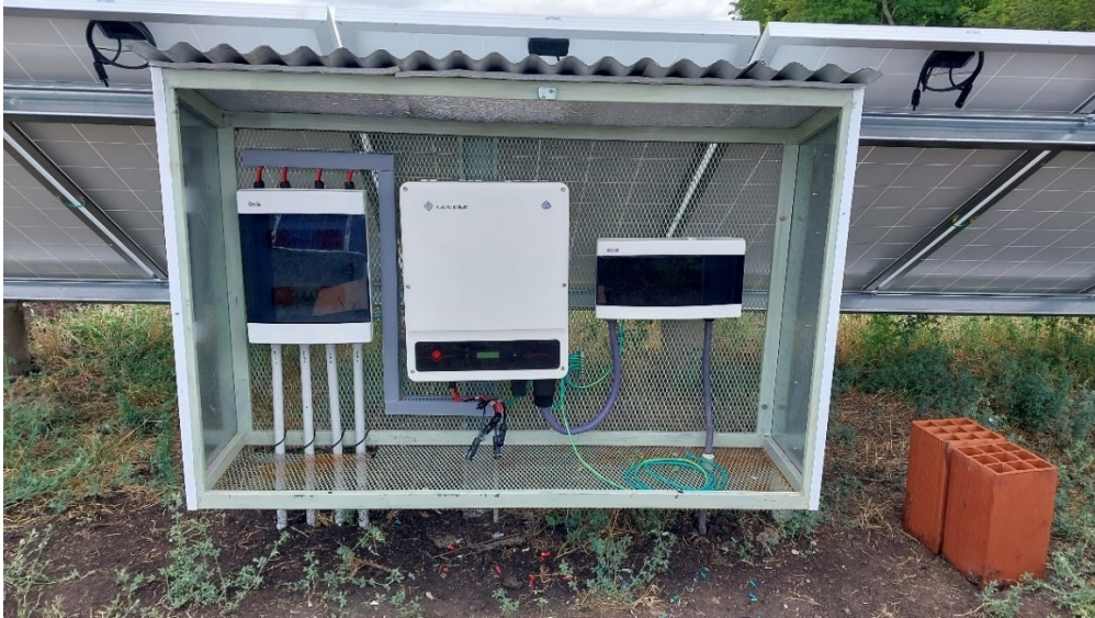
Figura 5.9. Gabinete del inversor y de los tableros de protección.
