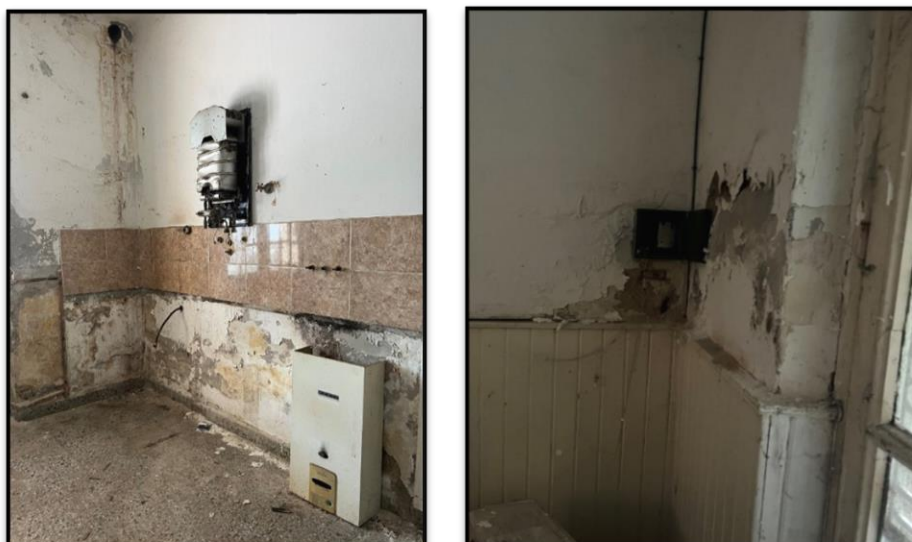
Figura N° 8 – Muros con humedad e instalaciones en mal estado
