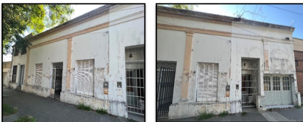
Figura N° 10 – Fachadas en buen estado, sin mantenimiento
