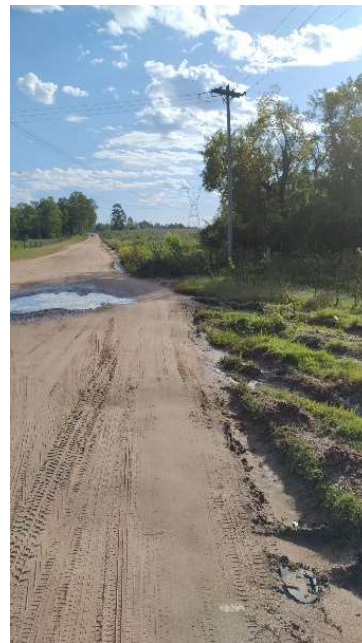
Imagen. 1.3-4 Deficiencia de drenaje de la calzada
