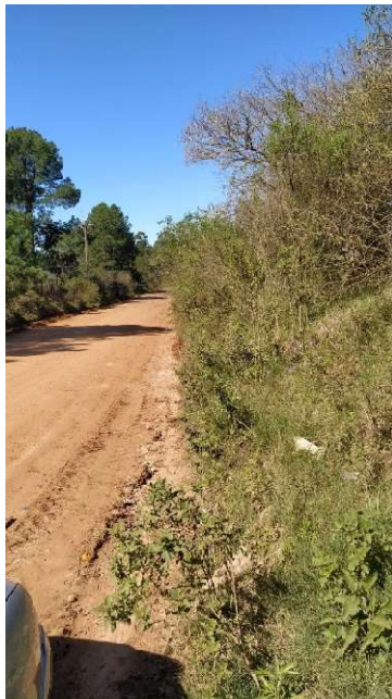
Imagen 1.3-3 Estado de la calzada
