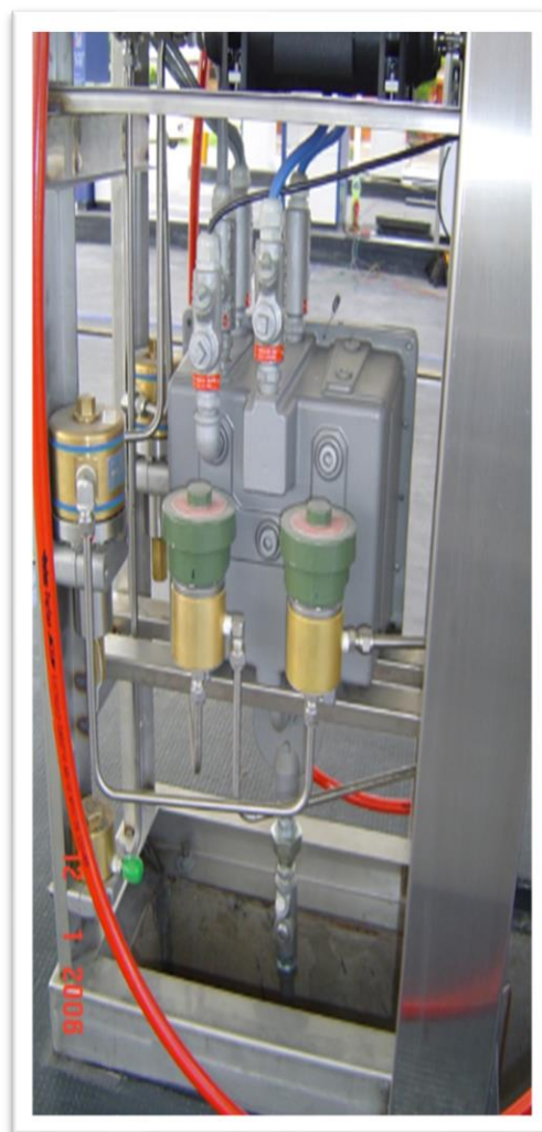
Imagen 12. Foto interior de componentes del surtidor de GNC
