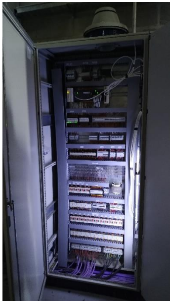
fig. n° 61: tablero de comando
