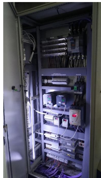
fig. n° 62: Tablero de potencia.
