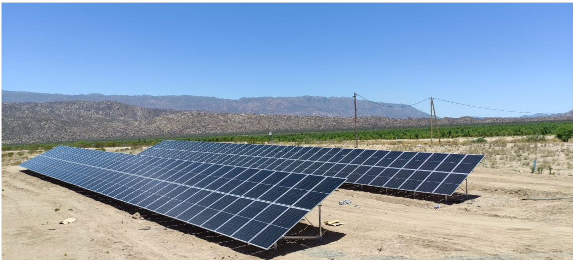
Imagen 26.2A: "Parque Solar Fotovoltaico Vista Larga" Fuente: Propia
