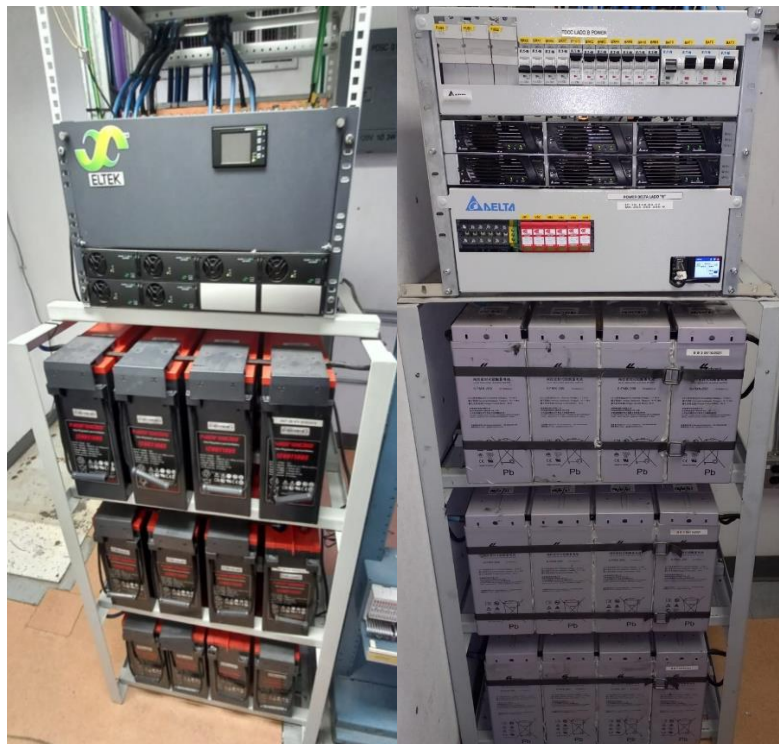
Figura N°. -20 Sitio Celular Claro – Banco de baterías.
