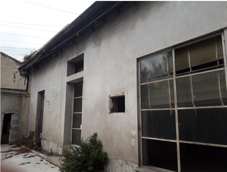
Foto 1: Fachada interior que da con patio hacia el norte con calle Minuzi.
