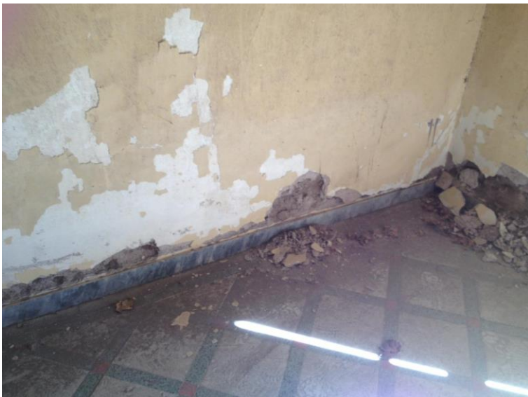
Foto 6: Deterioro en muro de adobe debido al paso del tiempo y grietas diagonal
