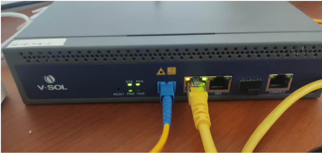
Figura 3 - OLT GPON VSOL V1600GS
